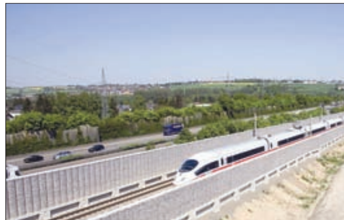
Lärmschutzwände aus Gabionen absorbieren mehr Lärm als zum Beispiel Plexiglas.
