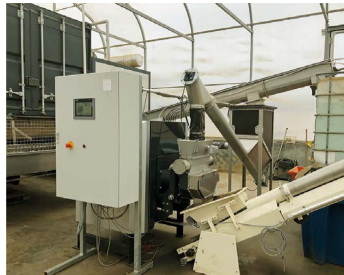
Erwartungen voll erfüllt: Der Anlagenbetrieb läuft problemlos. Bild: Jumbo
