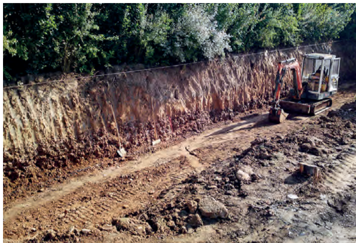
Untaugliche, dichte Böden behindern die Verwesungsprozesse auf unseren Friedhöfen. Die Folge sind nicht funktionierende Erdgräber.
