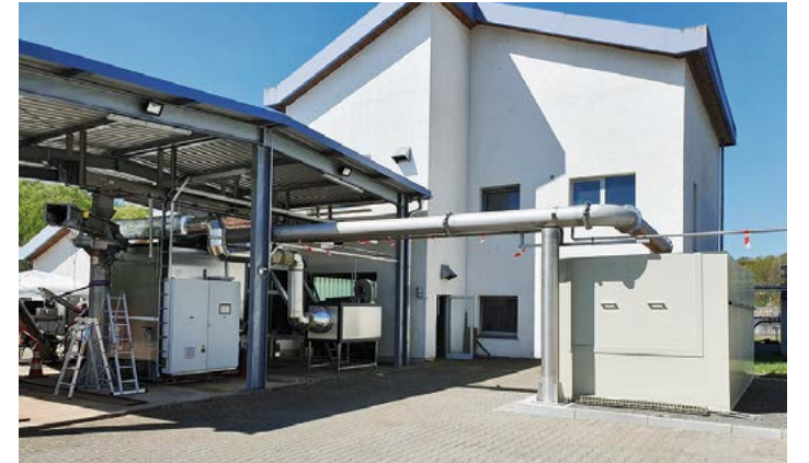
Auch im hessischen Bad Orb wird die neue Technologie seit April erfolgreich auf der Kläranlage eingesetzt. Bild: Jumbo Group
