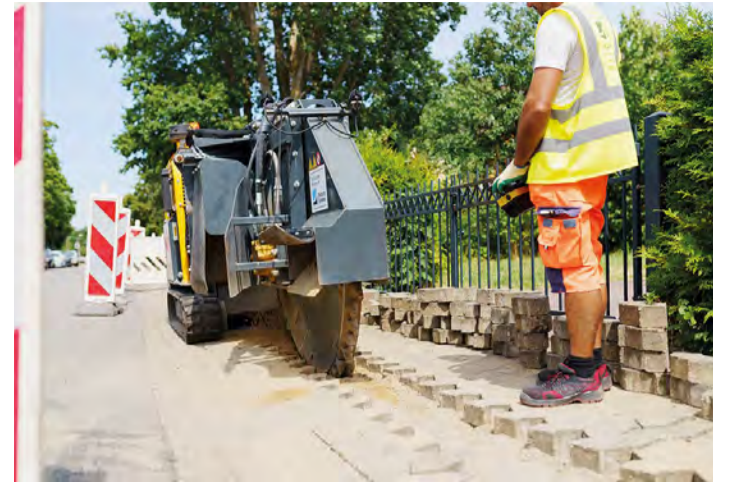
Minimalinvasive Verlegungsmethoden ermöglichen einen bis zu fünf Mal schnelleren Ausbau mit Glasfaser. Bild: Deutsche Glasfaser
