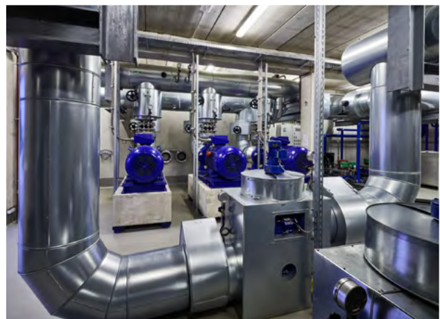
Energiezentrale der WVI GmbH &amp; Co.KG
