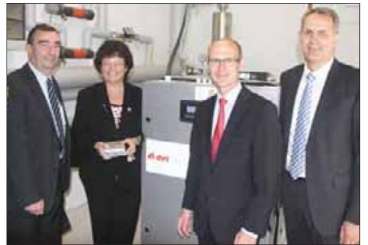
Unscheinbar aber wirkungsvoll: Das neue Mini-Blockheizkraftwerk des Modellversuchs „Smart Local Generation“ im Hintergrund ist kaum größer als eine normale Gebäudeheizung. Von links: E.ON-Projektleiter Dr. Roland Hofer, Osterhofens Bürgermeisterin Liane Sedlmeier, E.ON-Bayern Vorstand Egon Westphal und E.ON-Regionalleiter Ostbayern Christoph Henzel stellen den neuen Netzstabilisator jetzt der Öffentlichkeit vor. Foto: obx-news
