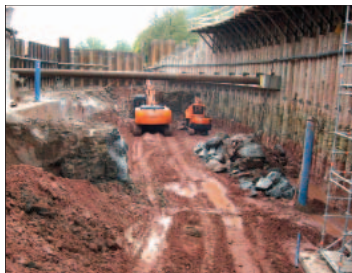
Die Baugrube zur Erweiterung des Mainkraftwerks Rothenfels der Rhein-Main-Donau. Bild: Rhein-Main-Donau AG
