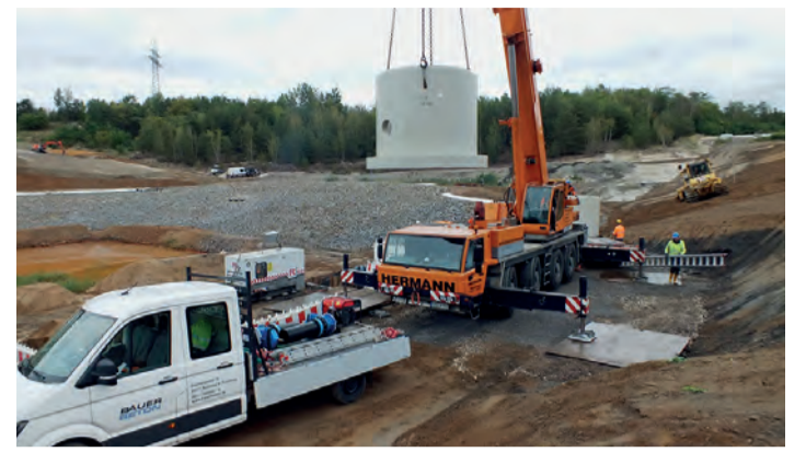
Einheben des 8,9-Tonnen schweren Basisteils von Saugpumpenschacht 1. Bild: Foto: Jan Kiver / Uniper SE
