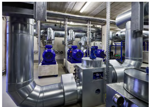
Energiezentrale der WVI GmbH &amp; Co.KG
